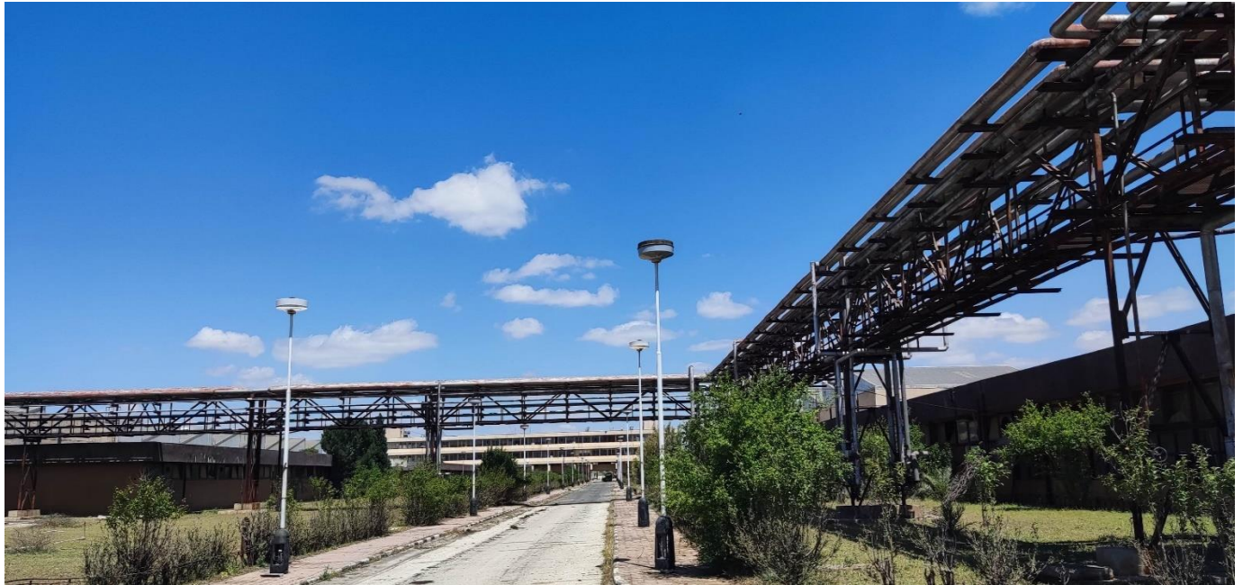
خطوط لوله انتقال UTILITY
