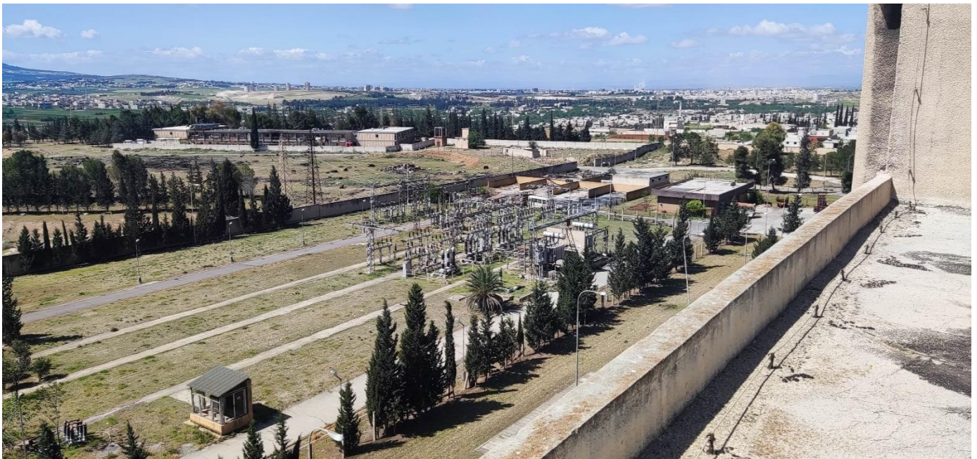
پست برق ۶۶ کیلووات
