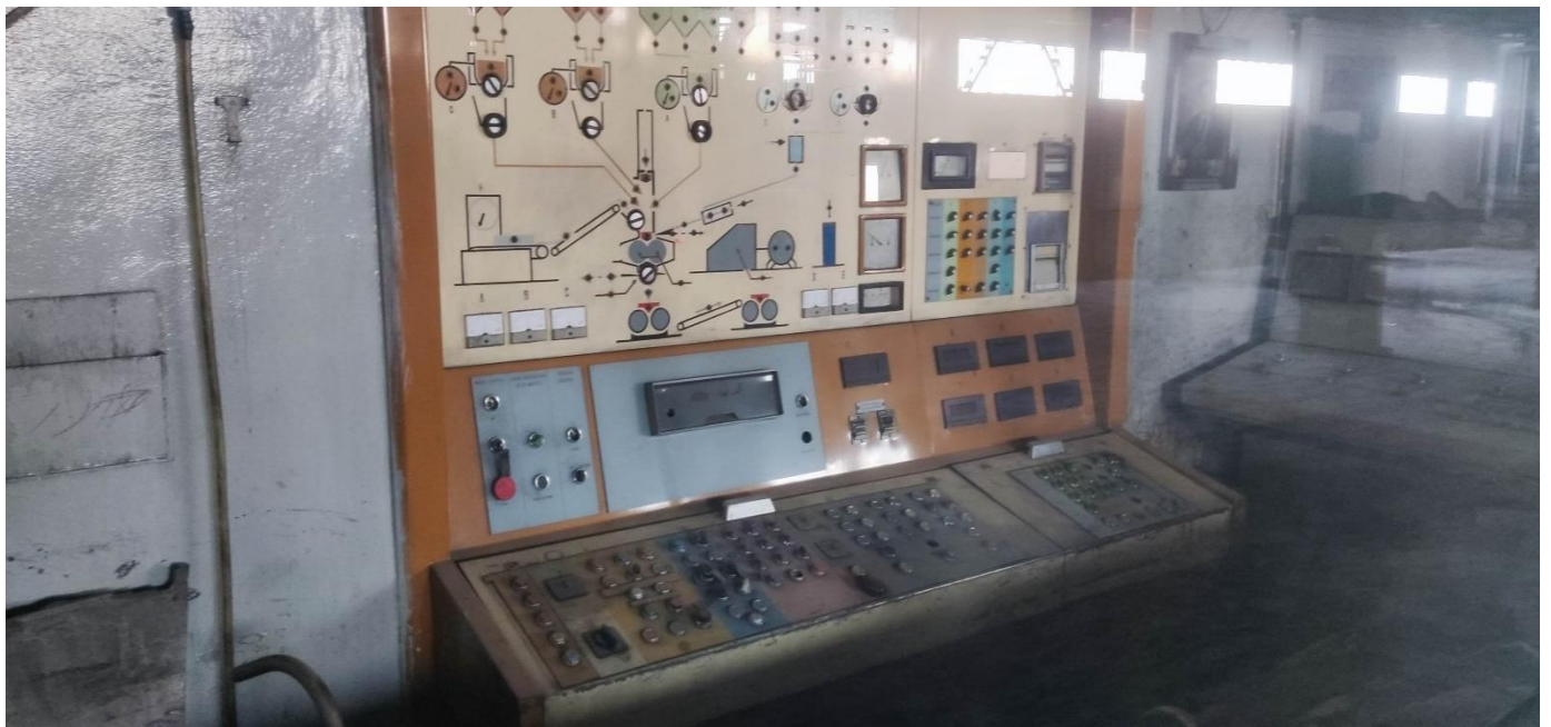
اتاق کنترل در بخش اختلاط
